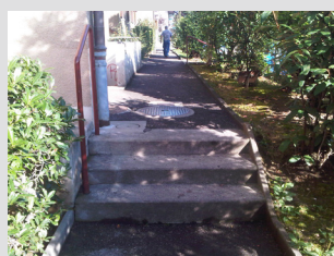
Illustrations 3.2 et 3.3 : Exemples d'obstacle sur un cheminement piéton. Que ce soit sur la route des Ravières (en bas) où sur le chemin du Pont (en haut) les obstacles à la déambulation des piétons peuvent être pénalisants, spécialement pour les personnes à mobilité réduite ou les poussettes.
