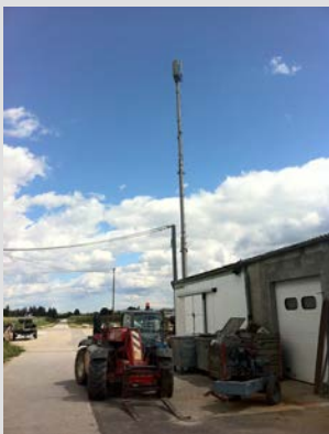
Illustration 4.47 : Antenne de téléphonie mobile Chemin des Marsins Source : BTEE SA
