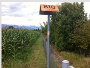
Illustration 4.52 : Signalisation du gazoduc Source : BTEE SA
